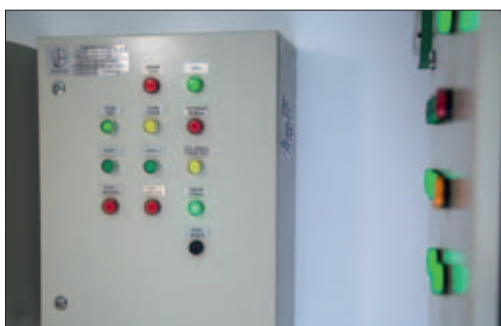
Рис. 3. Мобильное очистное сооружение – вид изнутри
